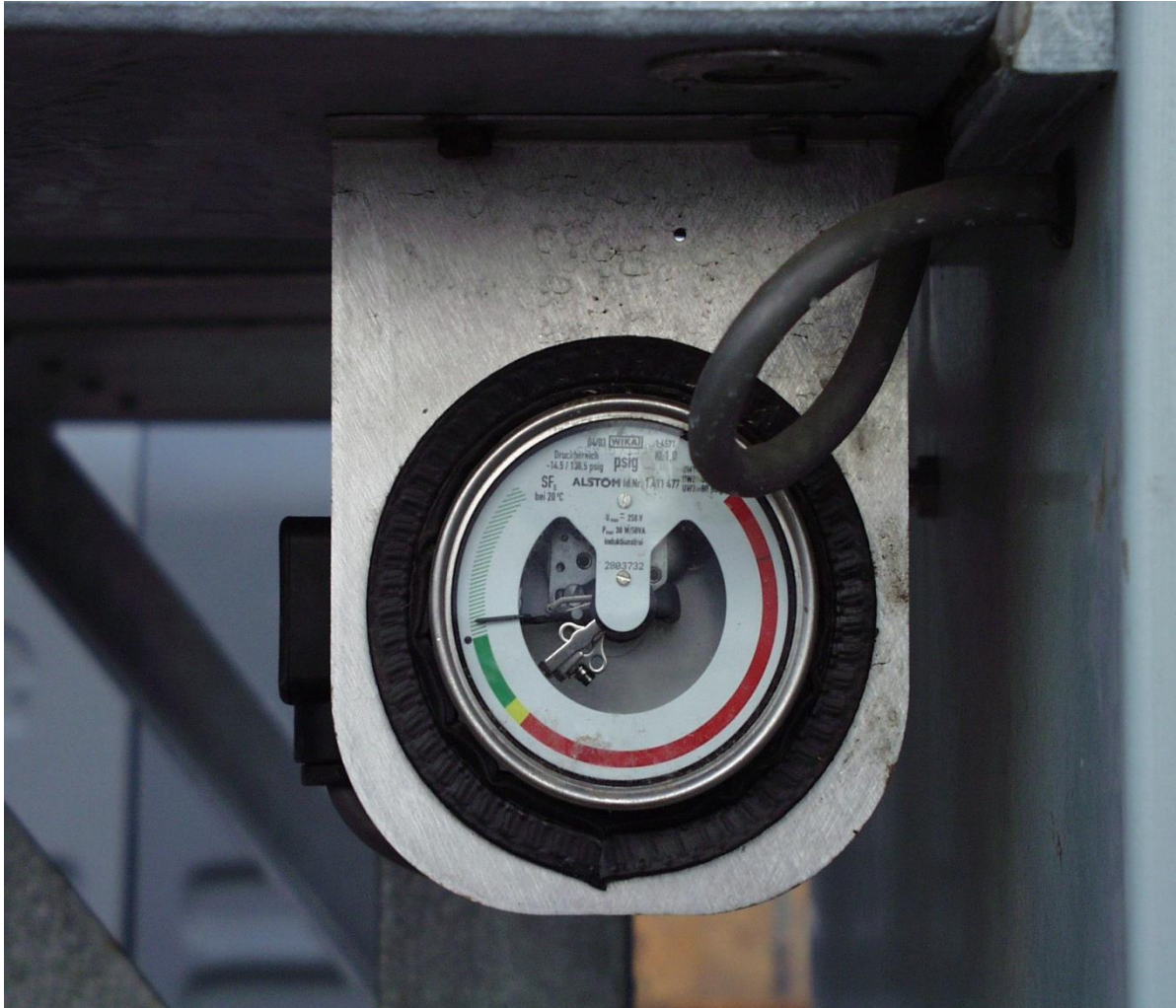
Manómetro de SF6 en CB 115kV (Alstom)
